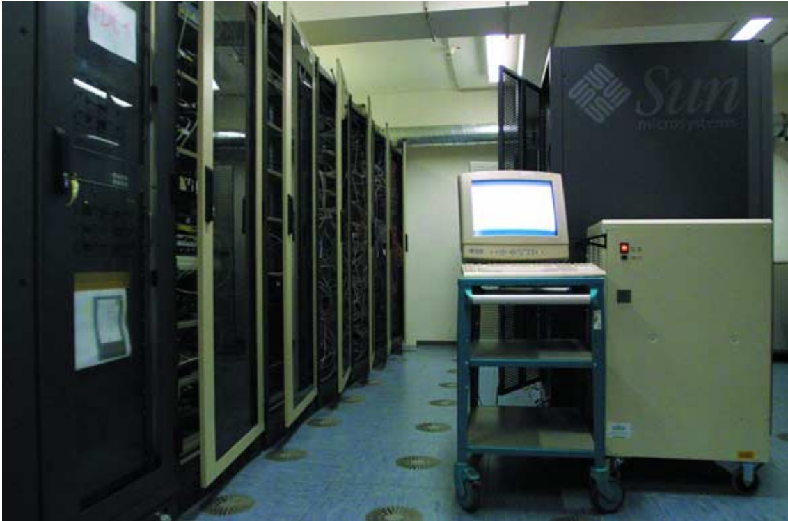
Ein Blick in das Rechenzentrum des DIMDI
